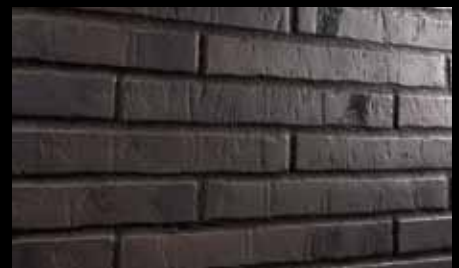
Готовый вид шва. Поверхность, выполненная плиткой из элементов, относящихся к эксклюзивной серии Glanzstücke.
