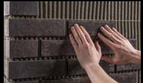
Укладка плоских клинкерных плиток с помощью шнура. Клинкерные плитки вдавливаются в слой клея.
